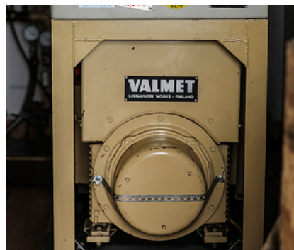
Dieser Generator wird seit 30 Jahren eingesetzt.
